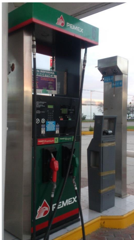
DISPENSARIO, SISTEMA DE COBRO ELECTRÓNICO Y RED DE AIRE Y AGUA A PRESIÓN.
