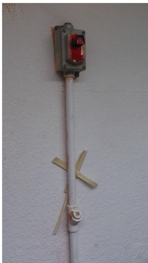
BOTONES DE PARO DE EMERGENCIA.
