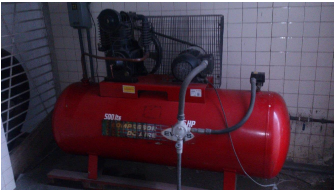
COMPRESOR DE AIRE DE LA RED.
