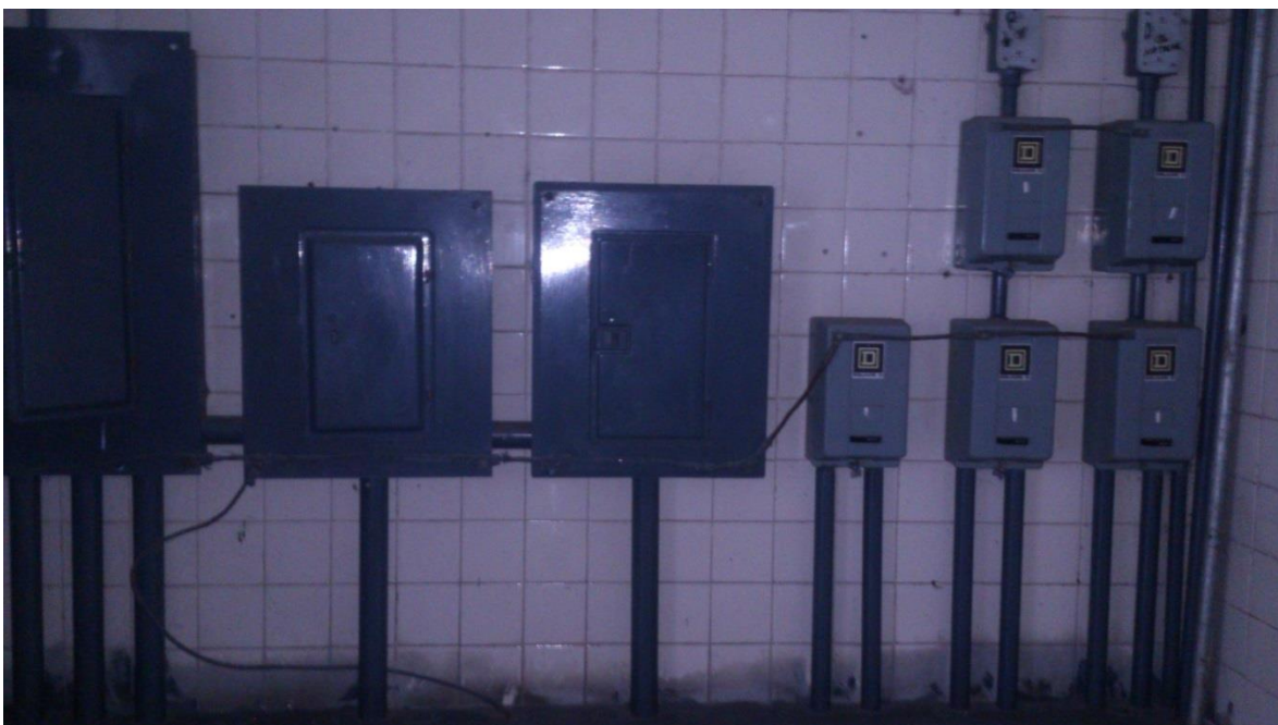
CUARTO DE CONTROL DE MOTORES.
